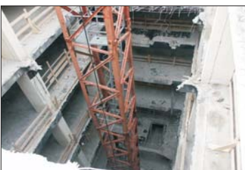
Kranstellung im Gebäude
